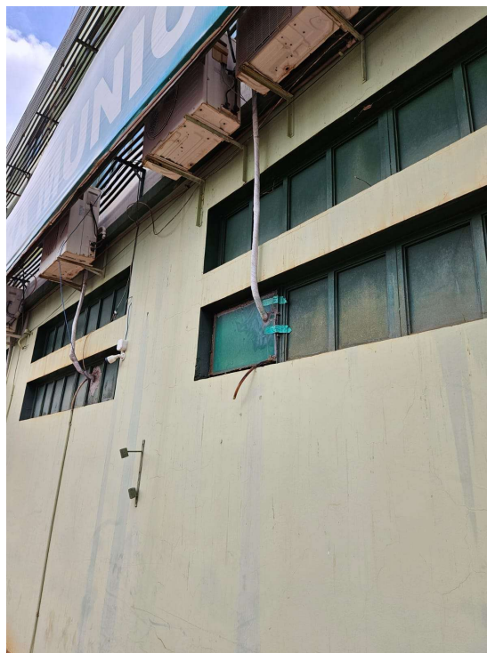
Figura 18: Remendos na instalação atual
