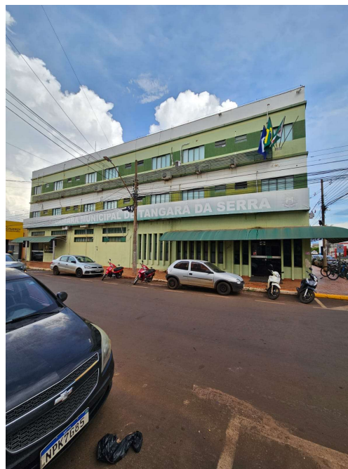
Figura 2: Fachada a ser recuperada
