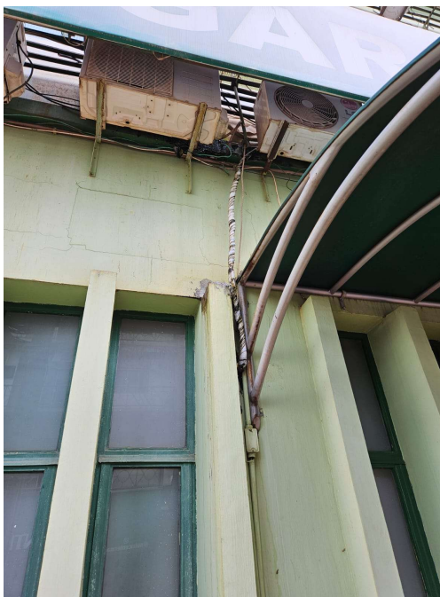
Figura 4: Vazamento e lodo nas paredes
