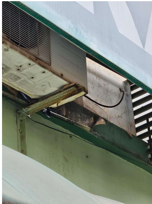
Figura 7: Infiltrações prejudicando a pintura
