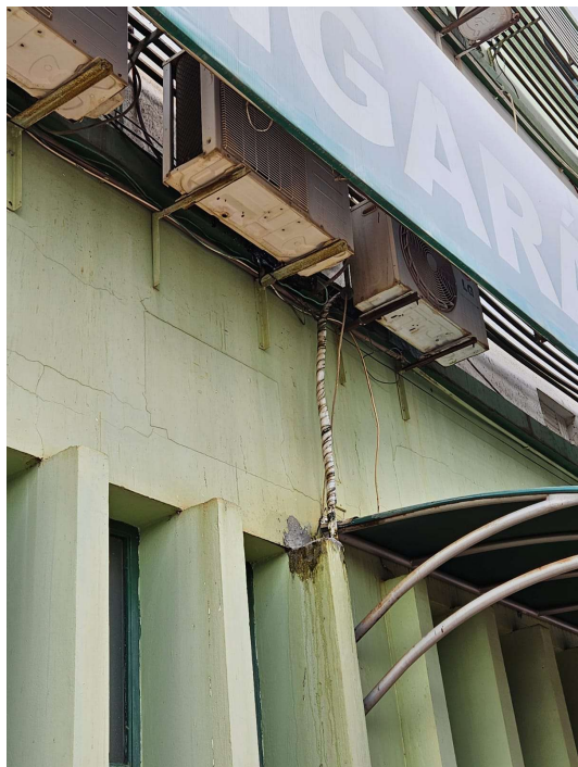
Figura 5: Rachadura e infiltrações
