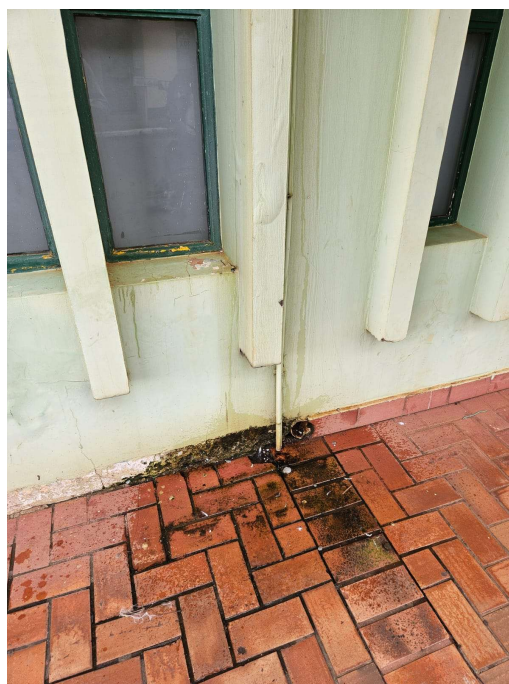
Figura 12: Calçada com lodo e prejudicada oferecendo risco a pedestres
