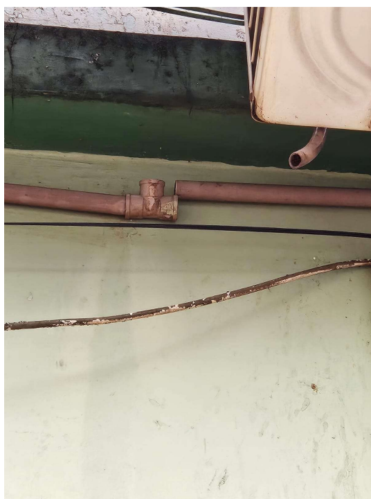
Figura 6: Tubulação atual danificada
