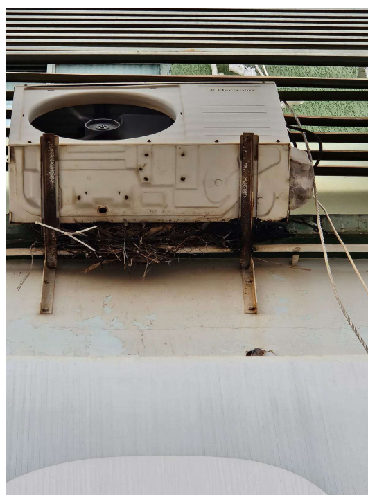
Figura 16: Dificil acesso para limpeza e manutenção
