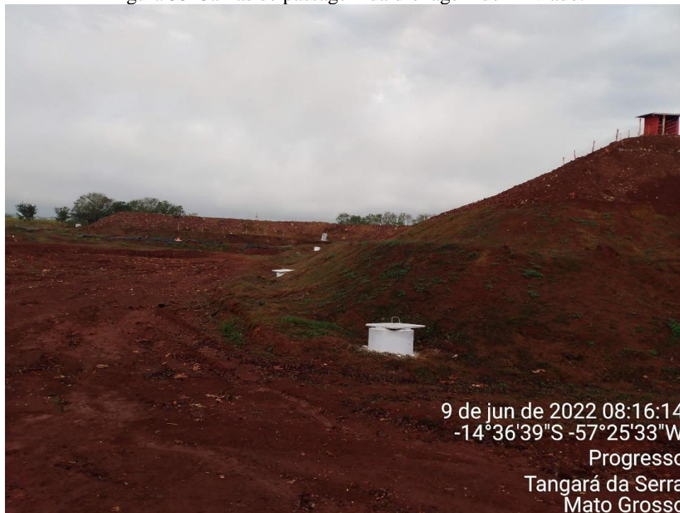
Figura 53-Caixas de passagem da drenagem de lixiviado.
