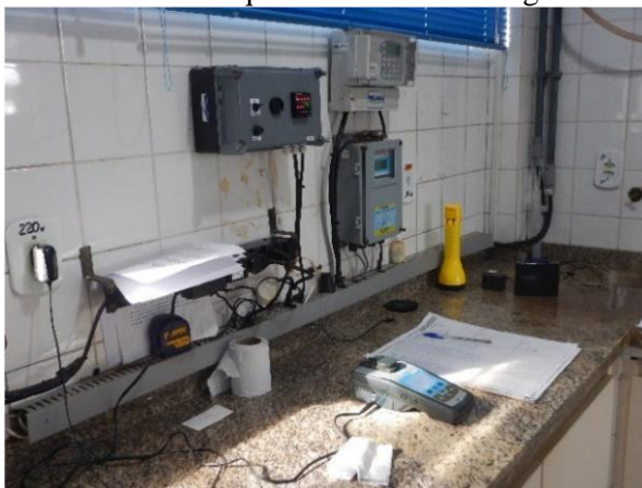
Figura 122-Laboratório de análises físico-químicas e microbiológicas da ETA Queima-Pé.
