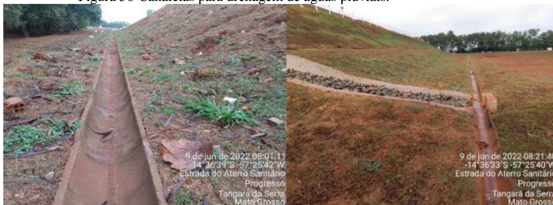
Figura 56-Canaletas para drenagem de águas pluviais.
