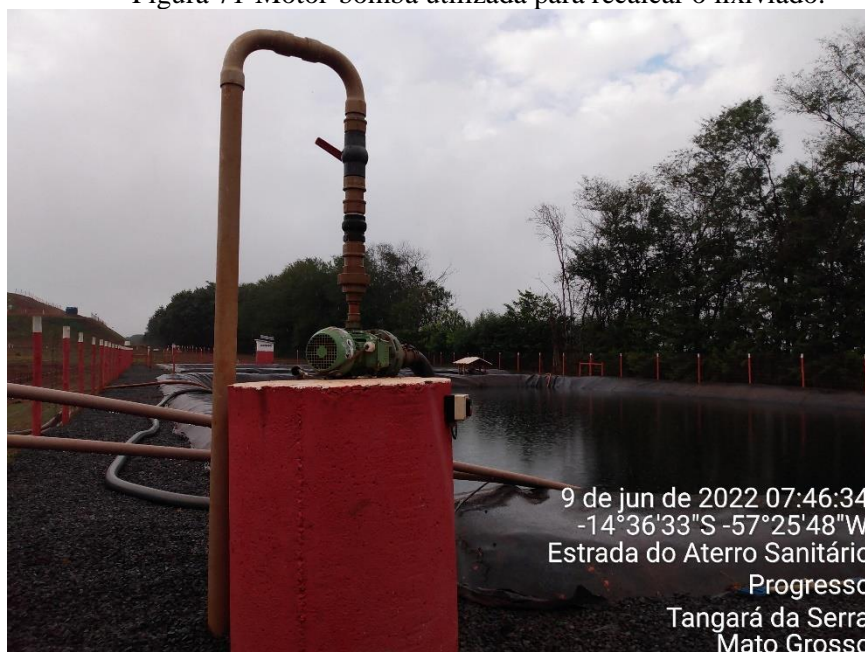
Figura 71-Motor-bomba utilizada para recalcar o lixiviado.
