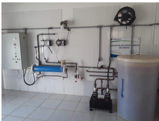
Figura 121-Gerador de hipoclorito de sódio.
