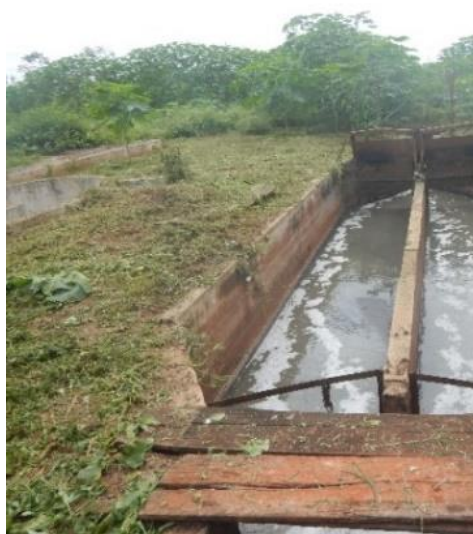
Figura 133-Caixa de remoção de areia da ETE.
