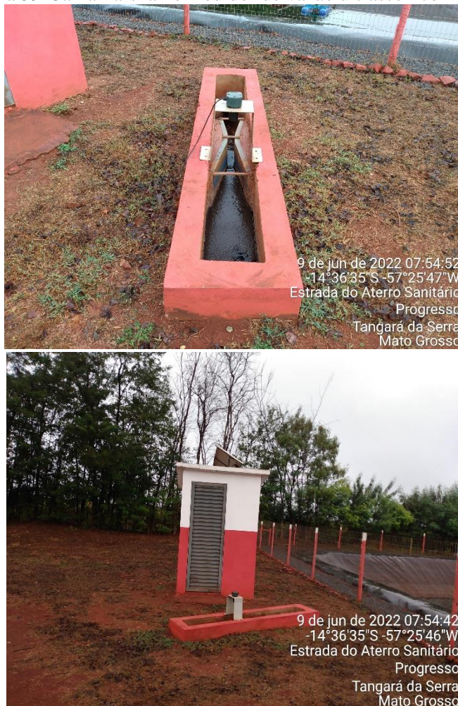
Figura 59-Calha Parshall e medidor de vazão ultrassônico
