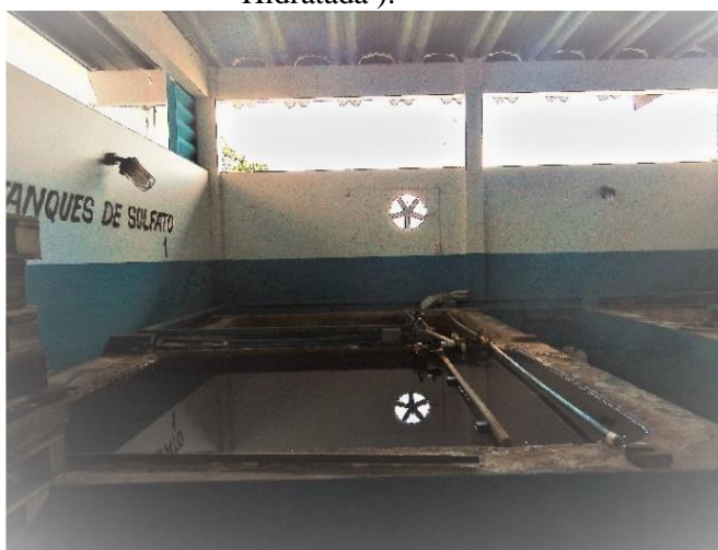
Figura 124-Tanques de preparo de soluções de produtos químicos (Sulfato de Alumínio e Cal Hidratada ).
